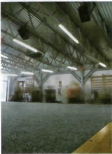
Fig. 3: Sul soffitto sono installati due JBL Control 5.
